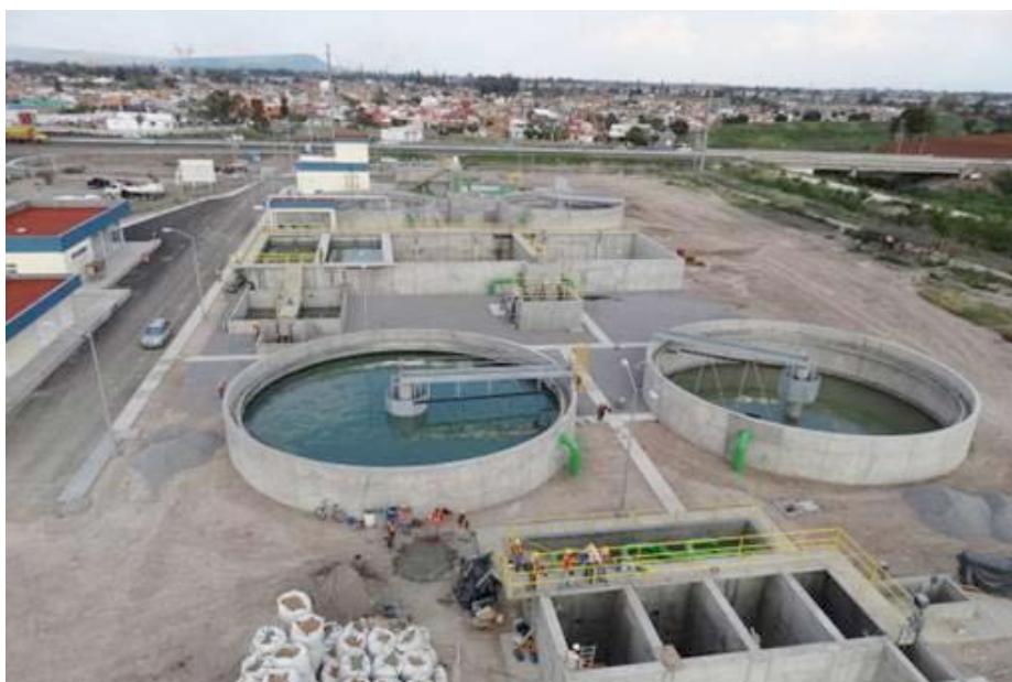
Planta de tratamientos residuales de Salamanca, estado de Guanajuato (México).
