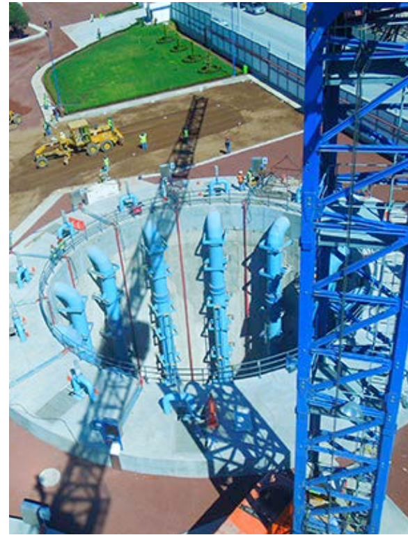
Vista área de uno de los cárcamos de la Planta de Bombeo El Caracol.
